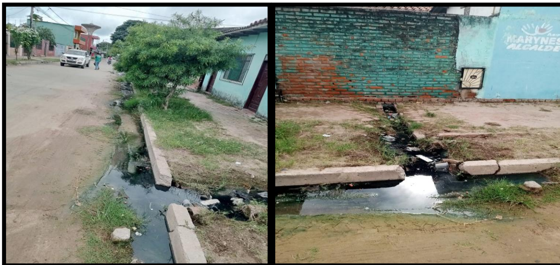
DISTRITO 2 , Atención a denuncia por descarga de Aguas residuales Zona Melchor Pinto.
